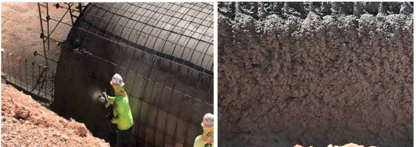
Fig. 8: Ondulación superficial por ángulo incorrecto
