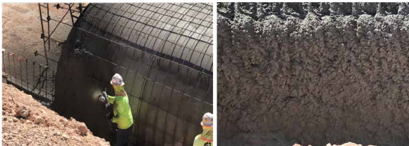
Fig. 8: Ondulación superficial por ángulo incorrecto
