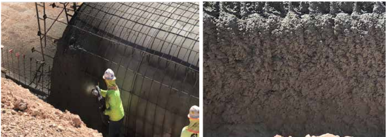
Fig. 8: Ondulación superficial por ángulo incorrecto
