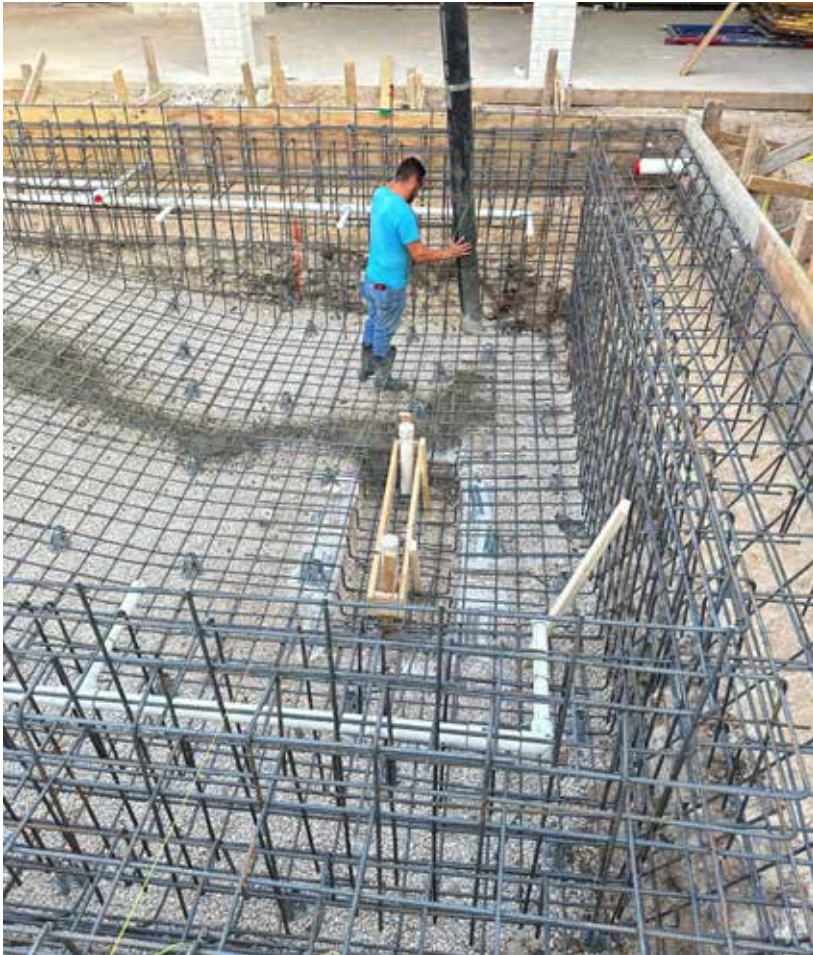
Fig. 2: Colocación de concreto en el piso de una alberca con bomba pluma.
