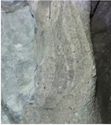
Fig. 4. Buna adherencia entre capas de concreto lanzado
