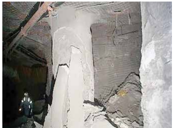
Fig. 5: Derrumbe del pilar debido a la falta de acero de refuerzo
