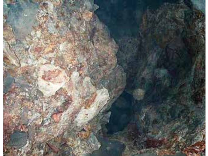
Fig. 4: Concreto lanzado muy delgado causó un colapso de la mina
