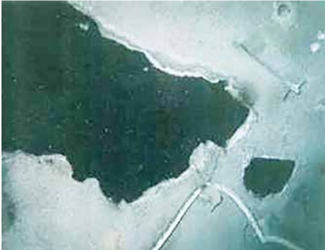
Fig. 2: Concreto lanzado muy delgado
