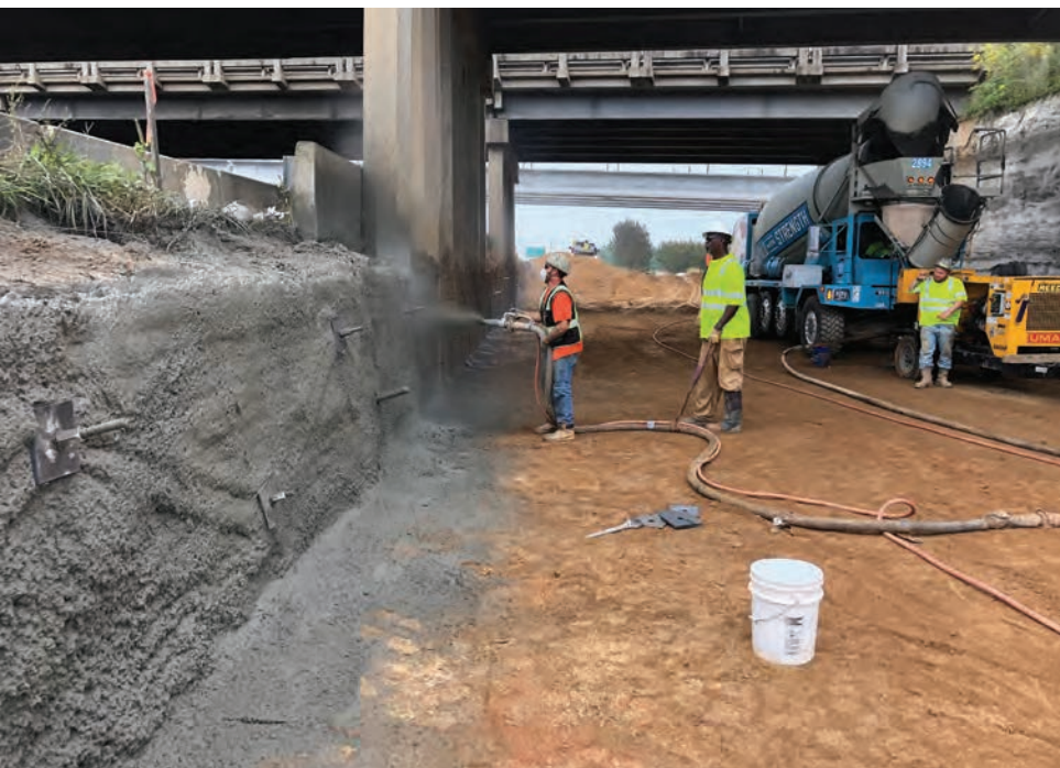
La retención de la tierra de UMA y el trabajo esculpido de la escopeta en el proyecto de mejoras de intercambio I-40/I-77 de NCDOT mantuvieron los cortes para tramos de carreteras más ampliados y facilitaron la construcción de nuevos puentes.
