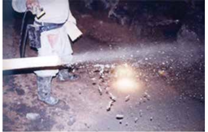
Fig. 4: El concreto lanzado es concreto lanzado acelerado neumáticamente a alta velocidad antes del impacto en la superficie receptora
