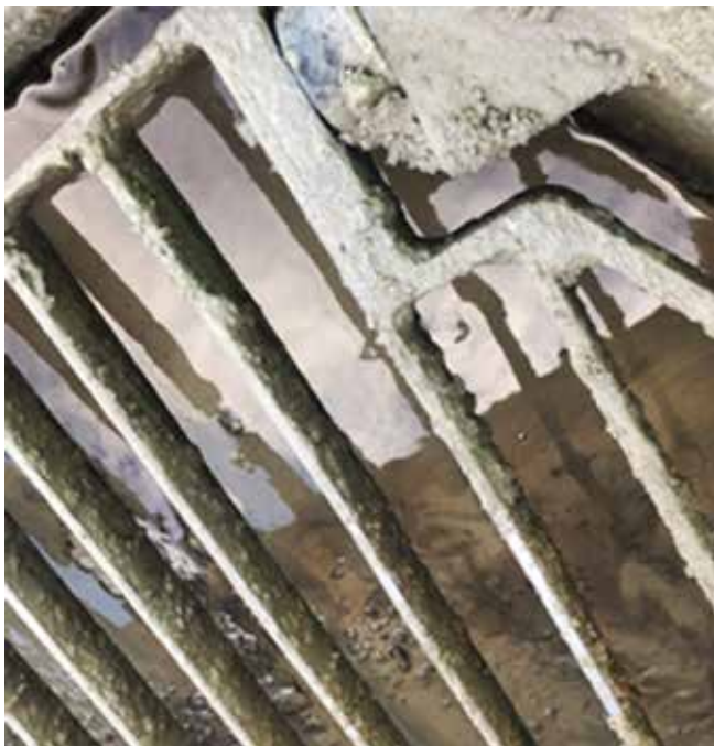
Fig. 1: Obviamente demasiada agua sobre el concreto en la tolva
