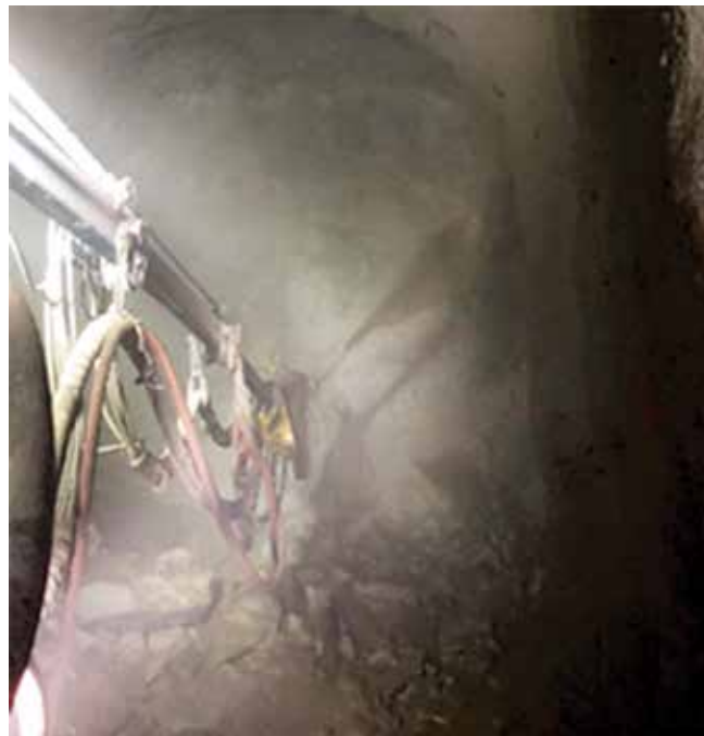
Fig. 2: Los aditivos juegan un papel importante en la producción de esta colocación subterránea de concreto lanzado
