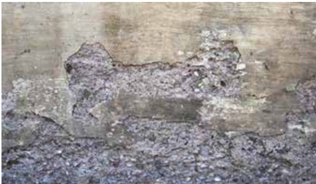
Fig. 6: Desconchamiento superficial severa en el concreto
