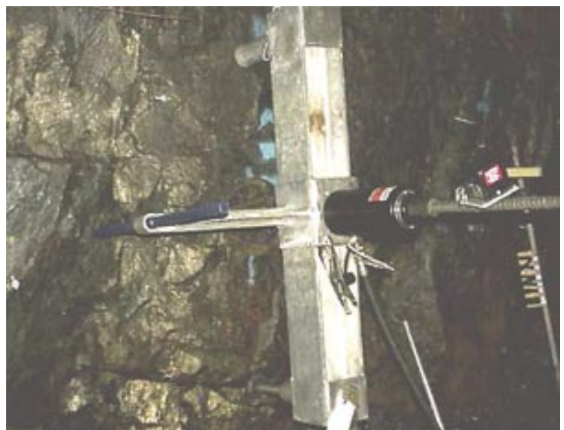
Figure 2: INCO loading (pulling) frame.
